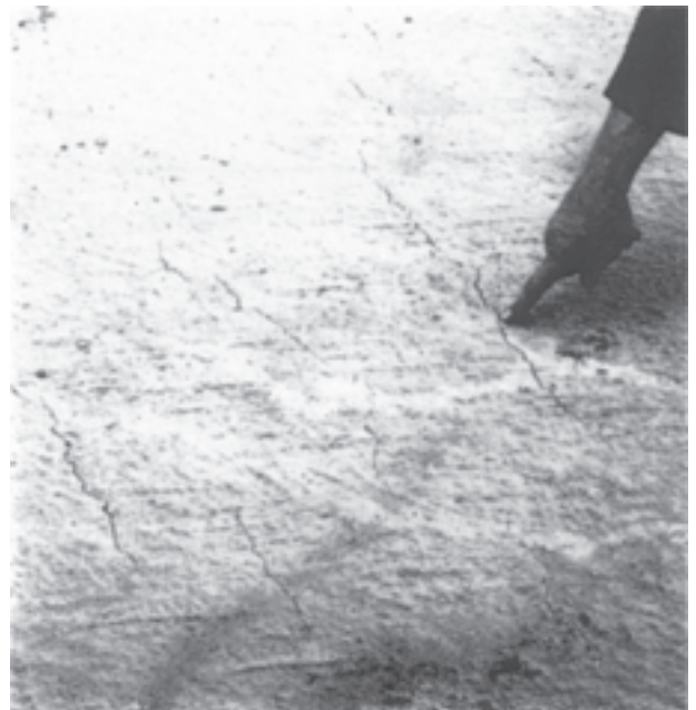
รูปที่ 12.4 Plastic Shrinkage Crack
