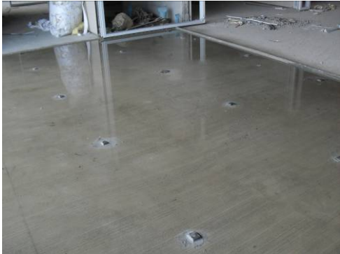
การขังน้ำที่ผิวคอนกรีตเดิม
