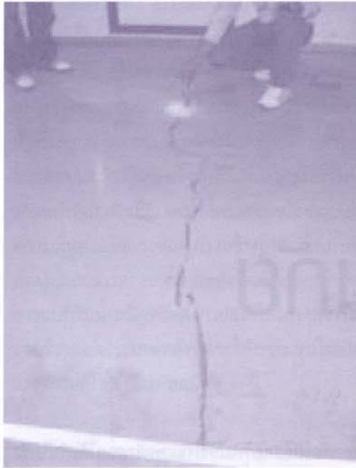
รูปที่ 11 แสดงรอยร้าวในพื้นเนื่องจากรับน้ำหนักบรรทุกเกินกำลัง
