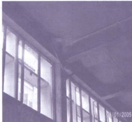
รูปที่ 6 แสดงรอยร้าวในเสาและพื้นจากสนิมเหล็กที่อยู่ใต้พื้นห้องน้ำ
