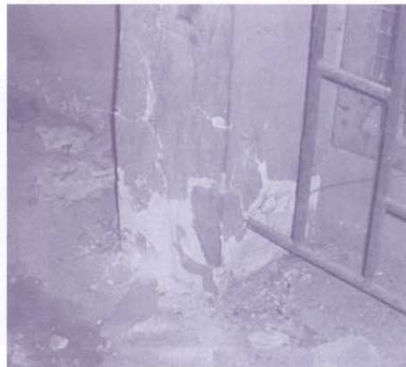
รูปที่ 9 แสดงรอยร้าวในเสาที่รับแรงเกินกำลัง
