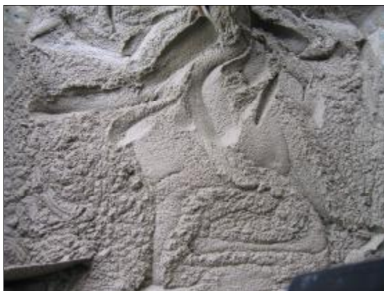
รูปที่ 26 สภาพเนื้อคอนกรีตของ M1 : M0F006A
