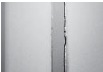
รูปที่ 6-16 ผนังแตกร้าวบริเวณขอบเสาในแนวตั้ง เนื่องจากการไม่ได้เสียบหรือเสียบเหล็กหนวดกุ้งไม่ถูกวิธี หรือไม่ได้ทำเสาเอ็น
