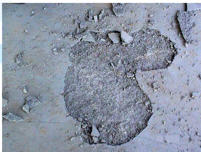
รูปที่ 6 การหลุดร่อน (Delaminating and Blisters)
