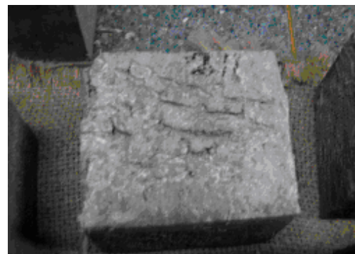
รูปที่ 19 ลักษณะของผิวคอนกรีตที่หลุดร่อนจากการใช้ปริมาณน้ำยามากเกินไป
