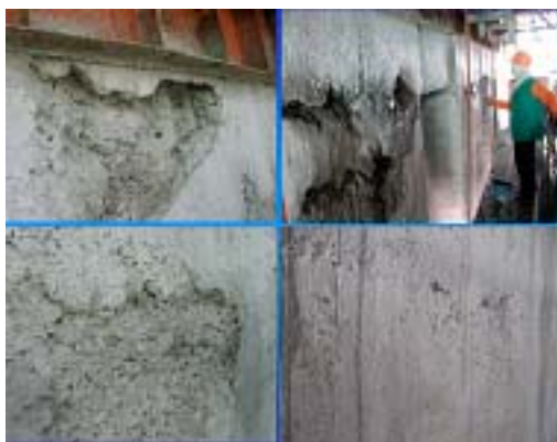
รูปที่ 7 สภาพความเสียหายของผิวคอนกรีตของโครง สร้างปล่องลิฟท์ที่ใช้ SLIPFORM ของอาคารประสาน มิตรธานี
