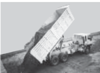
ข) รถบรรทุกเทท้ายใช้ในการลำเลียงและการเทคอนกรีตงานเขื่อน และงานพื้นสนามบิน
