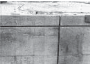
รูปที่ 13-33 การเทคอนกรีตทับบนชั้นคอนกรีตซึ่งเริ่มก่อตัวแล้ว ทำให้เกิดรอยต่อระหว่างชั้นการเท (Cold Joint) ขึ้น 10
