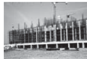
ข) ใช้ทาวเวอร์เครนยกถังเหล็กในการลำเลียงคอนกรีตไปเทยังอาคารชั้นบน ๆ
