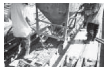
รูปที่ 13-23 การเทและการอัดแน่นคอนกรีต เป็นขั้นตอนการทำคอนกรีตที่ดำเนินไปพร้อม ๆ กัน
