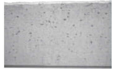
รูปที่ 13-14 เวลาผสมคอนกรีตน้อยเกินไป ทำให้ผิวคอนกรีตมีช่องว่างอากาศ (ตามด) มาก
