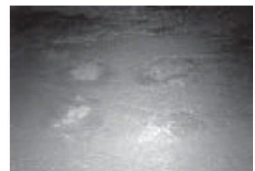
รูปที่ 12-12 การเยิ้มของน้ำและน้ำยา ขึ้นมาที่ผิวหน้าคอนกรีตเฉพาะจุด
