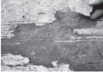
รูปที่ 12-14 ผิวหน้าคอนกรีตเกิดเป็นชั้นบาง ๆ ที่เรียกว่า Laitance ทำให้หลุดลอกเป็นแผ่น ๆ ซึ่งมีสาเหตุมาจากการแต่งผิวหน้าคอนกรีตในขณะที่ยังมีน้ำเยิ้มอยู่
