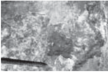
รูปที่ 12-22 คอนกรีตไม่แข็งตัวหรือมีเนื้อเยื่อ มีสาเหตุมาจากการใช้สารหน่วงการก่อตัวมากเกินไป
