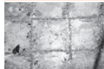
รูปที่ 12-17 ลักษณะรอยแตกร้าวเนื่องจากการทรุดตัวในขณะกำลังก่อตัว (Plastic Settlement Crack)
