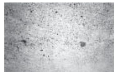
รูปที่ 12-13 การเยิ้มของคอนกรีตที่มากเกินไป ทำให้ผิวหน้าคอนกรีตเป็นฝุ่นได้ง่าย
