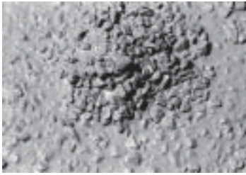
รูปที่ 12-8 เนื้อคอนกรีตสดเกิดการแยกตัว
