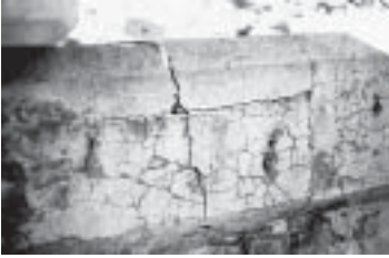
รูปที่ 9-58 ความเสียหายของโครงสร้างคอนกรีตที่เกิดจากปฏิกิริยาระหว่างต่างกับมวลรวม (Alkali-Aggregate Reaction; AAR)
