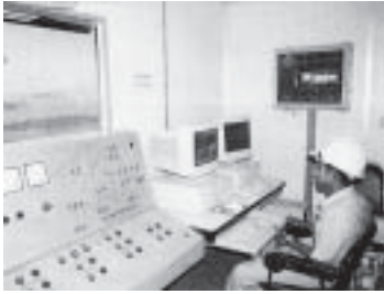
รูปที่ 9-32 ห้องควบคุมคุณภาพการผลิตและระบบควบคุม PLC
