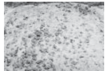
รูปที่ 8-15 คอนกรีตที่ไม่ดี ในสภาพที่เป็นคอนกรีตสดเกิดการแยกตัวระหว่างมอร์ตาร์กับมวลรวมหยาบ
