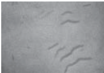
รูปที่ 7-19 ปูนฉาบแตกร้าว เนื่องจาก การฉาบปูนชั้นที่สองเข้าเกินไป
